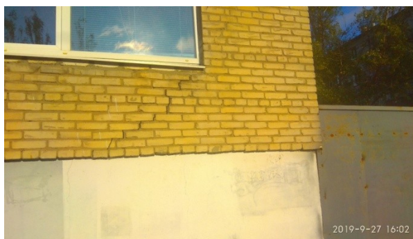
Рис. 1. Характерні тріщини в зовнішній стіні
