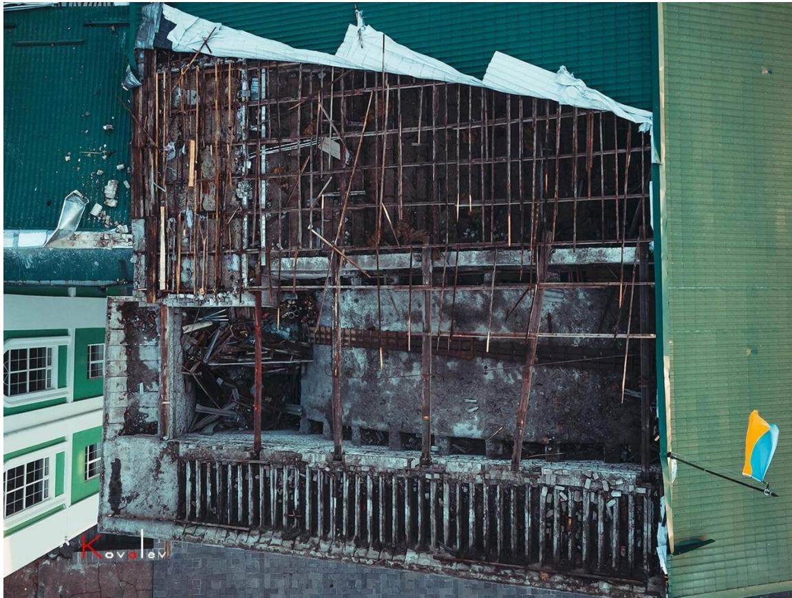
Рисунок 1 – Наслідки аварії. Будівля ДК ім. Хіміків
